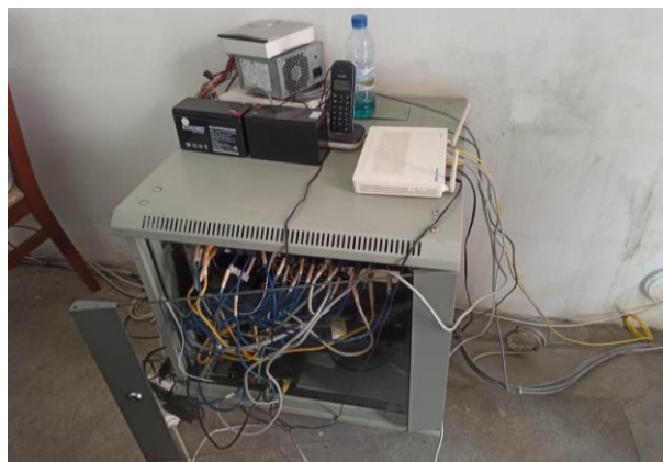
Figura 5 - Armário da rede existente
