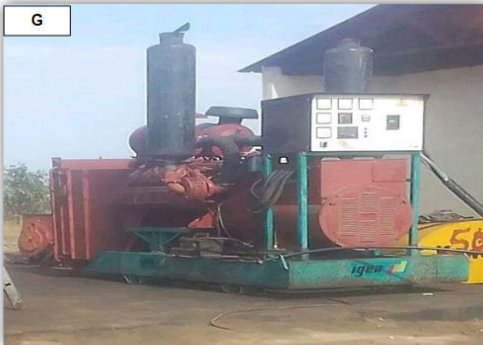
G- Grupo gerador da localidade Onakahambo
